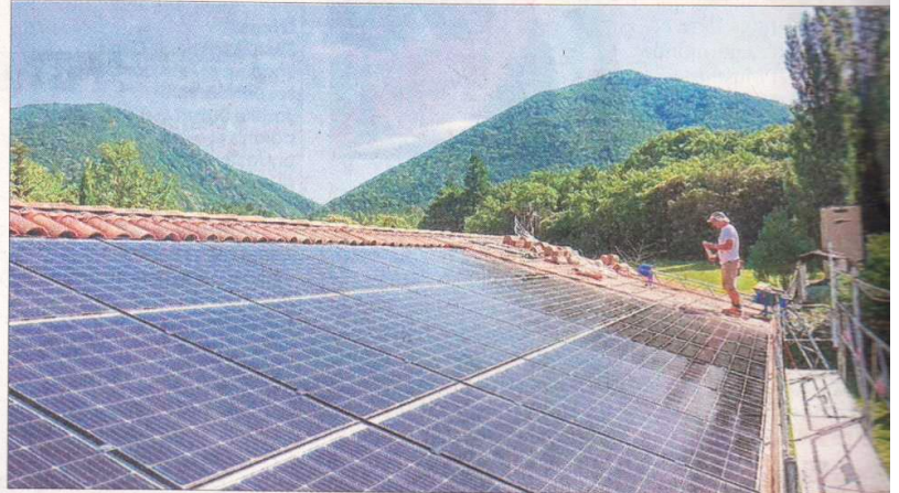
Le Parc des Baronniees est historiquement engagé dans la thématique des énergies renouvelables et a été « un des membres fondateurs de la démarche des centrales villageoises ». La puissance installée sur toitures s'élève aujourd'hui à plus de 365 kWc, soit un productible de 459 MWh/an. Photo Audrey MATT/PNR BP
